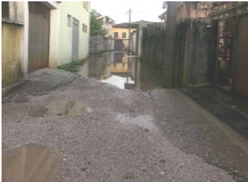
Foto evidentuese - shpjeguese të gjëndjes aktuale të rrugës
