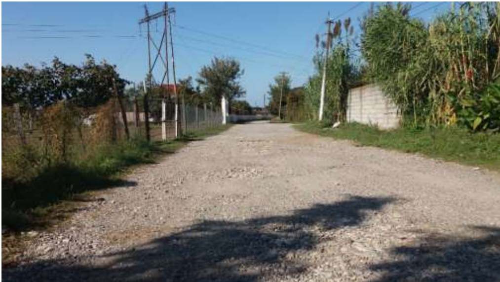
Foto evidentuese-shpjeguese të gjëndjes aktuale të rrugës
